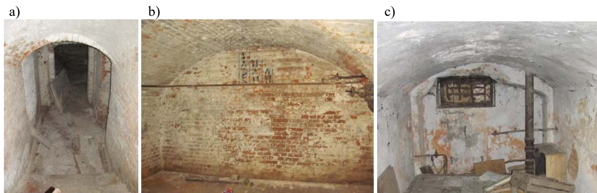
Рис.11.Стан будівлі по вул. Стрілецькій в Чернігові: а – вхід в підвал; б,с – стан підвалу.
