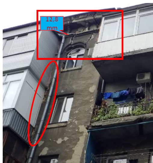
Рис.3. Тріщини в стінах будинку №67. Fig.3. Cracks of building №67.
