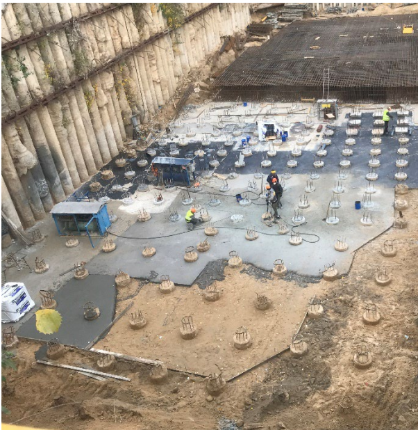
Рис. 8 Застосування буронабивних паль в якості огорожуючих та фундаментних конструкцій на майданчику будівництва споруди з підземним паркінгом по пр. Перемоги, 42 у м. Києві
