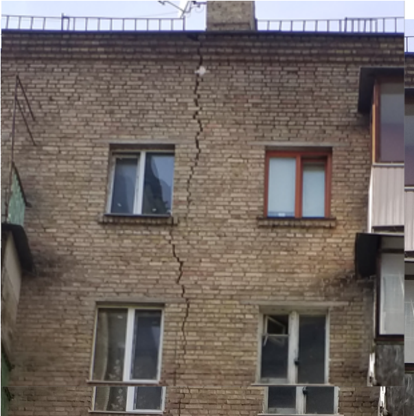
Рис. 1. Приклад впливу нового будівництва із підземним паркінгом на сусідній будинок.
