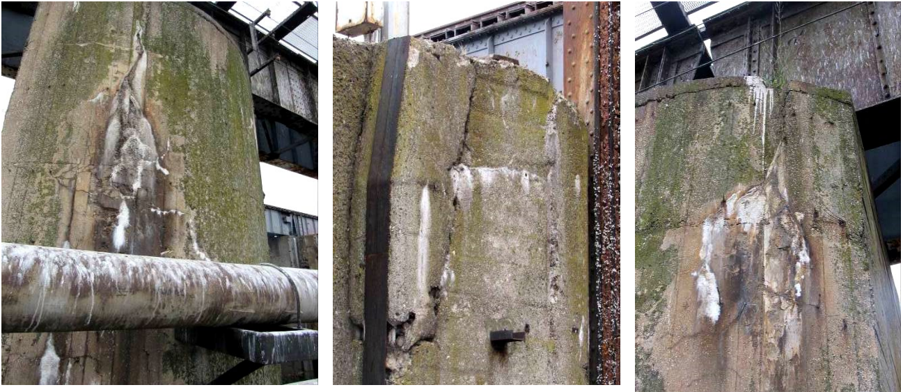
Рис. 7. Руйнування захисного шару бетону, оголення та корозія арматури, сколи, висоли, тріщини (відповідно опори №№ 10, 11, 12 з боку верхнього б'єфу)
