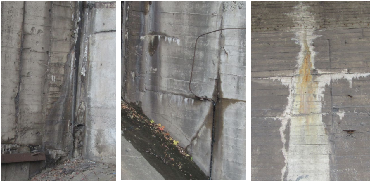
Рис. 8. Руйнування захисного шару бетону, тріщини шириною розкриття до 5 мм, висоли, неякісне бетонування, фільтрація (опори №№ 46, 47, 48 з боку нижнього б'єфу)
